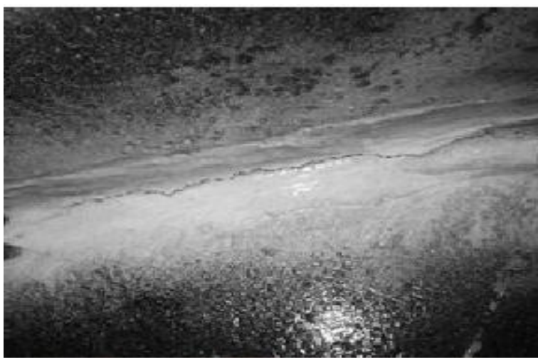
Рисунок 6 – Выявление усталостной трещины
